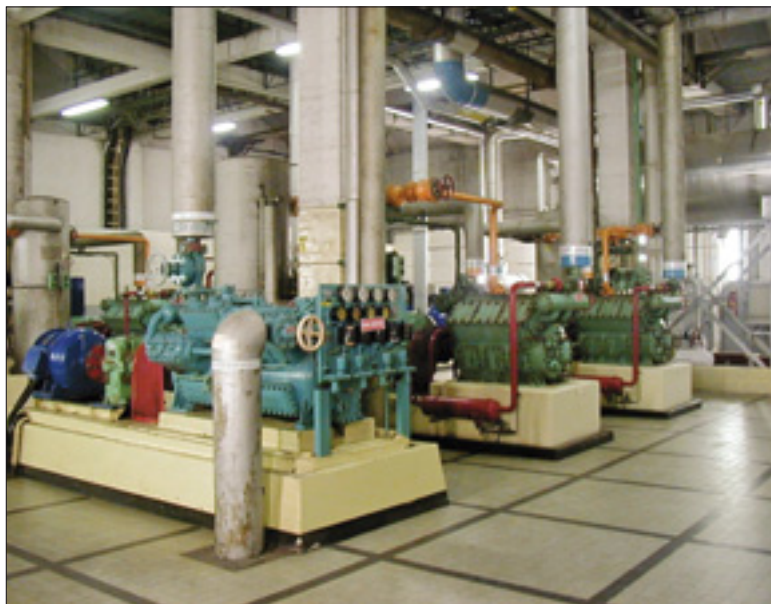
Figure 20. Salle des machines.
