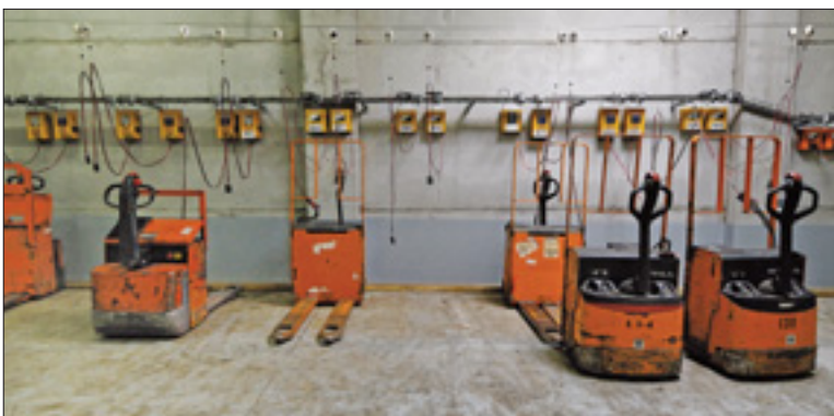
Figure 24. Local de charge de batteries.
