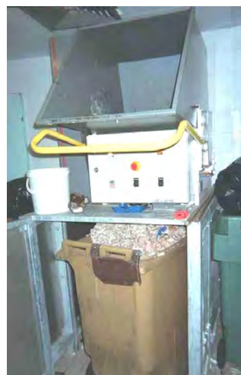
broyeur installé dans une cuisine centrale produisant 3000 repas/j [doc. COSTIC]
