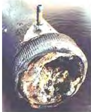
Canalisation colmatée par les résidus graisseux [source Big Dipper-Thermaco]
