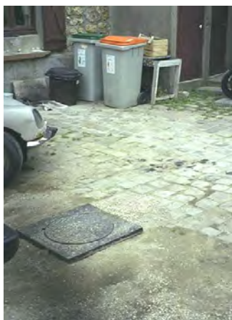
Accès au bac à graisses dans la cour interne d'un restaurant [doc. COSTIC]
